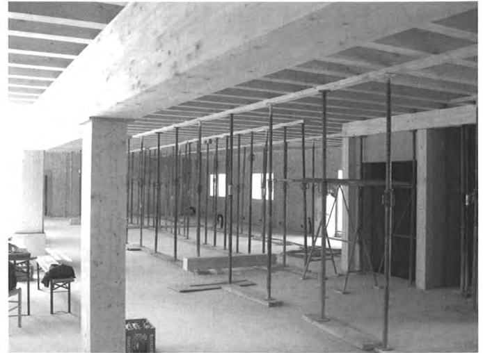
Bild 3: Holz-Beton-Verbund-Decke im Neubau – Untersicht der Balkendecke mit sichtbarer Brettverschalung zwischen den Brettschichtholzbalcken. Foto: Bahmer
