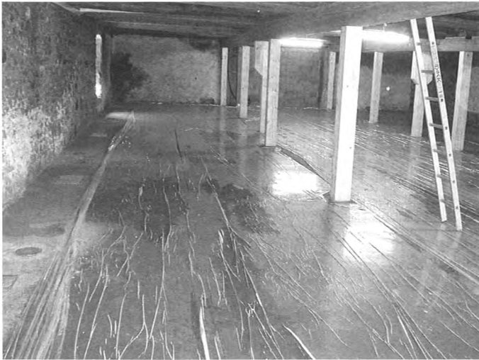
Bild 2: Holz-Beton-Verbund-Decke im Altbau – Ertüchtigung von bestehenden Holzbalkendecken zu Holz-Beton-Verbund-Decken. Nachbehandlung des Betons durch flächiges Abdecken mit einer Folie. Foto: Bletz
