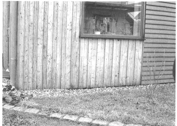
Bild 17 Nicht ausreichende Spritzwasserfreiheit einer Holzfassade
