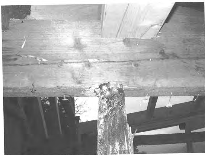
Bild 6 Bestehendes Pfettenauflager auf einer durch Brand geschädigten Holzstütze
