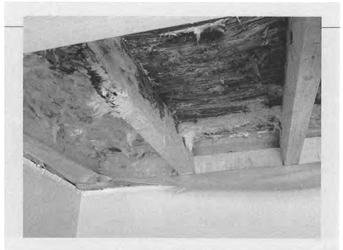
Bild 20 Pilzschäden innerhalb eines Flachdaches infolge Wasserdampfkonvektion
