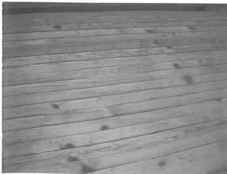
Bild 13: Umfangreiche Rissbildung in einer Eissporthalle Bj. 1990
