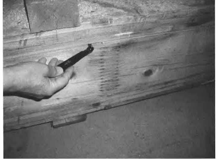
Bild 8: Geschädigte Fuge Steg-Gurt
