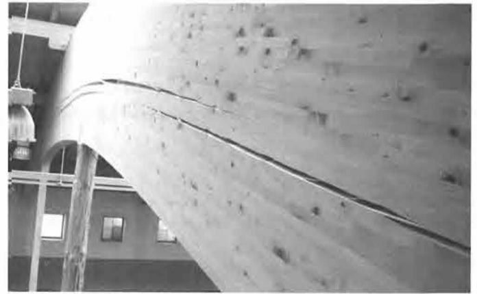
Bild 5: Gekrümmter Träger mit Riss
