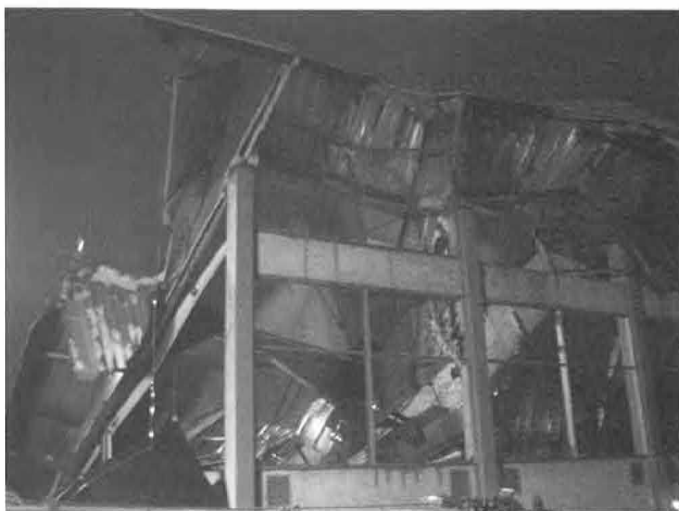
Bild 2: Teilansicht des eingestürzten Tragwerks
