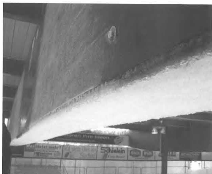
Bild 14: Eisbildung am Untergurt oberhalb der Eisfläche
