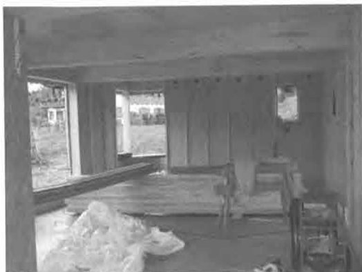
Bild 1: OSB als Konstruktionsplatte im Einfamilienhaus
